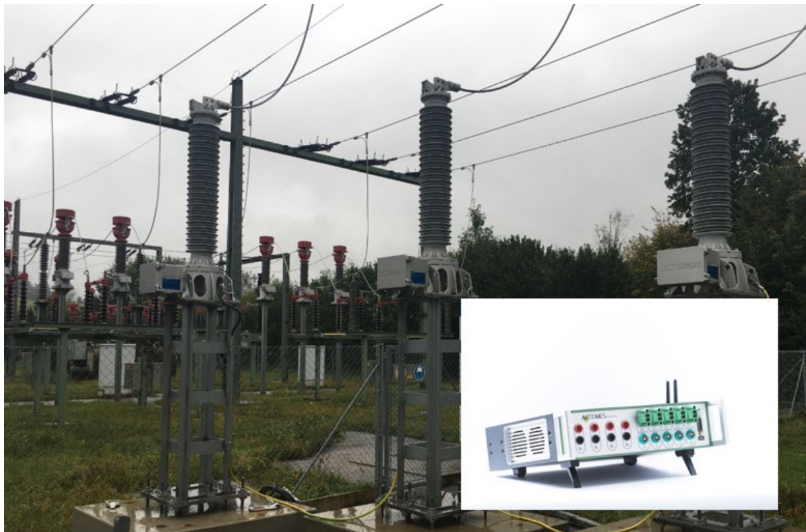
Abbildung 6: Kapazitive Teiler für 110kV und Messgerät AM-10-PA2H von ARTEMES
